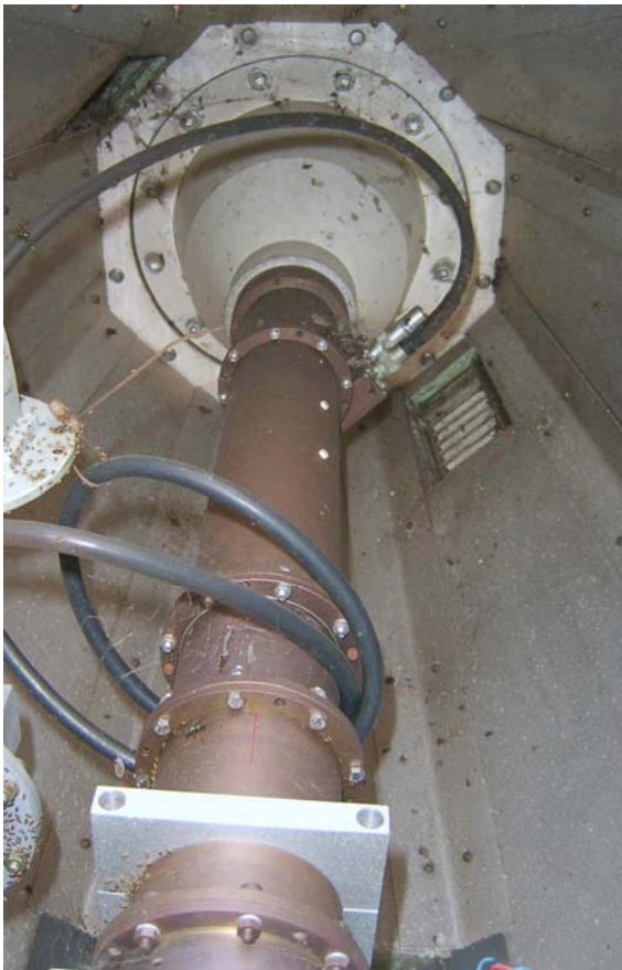
Übergang auf Hohlleiter Im Sockel
